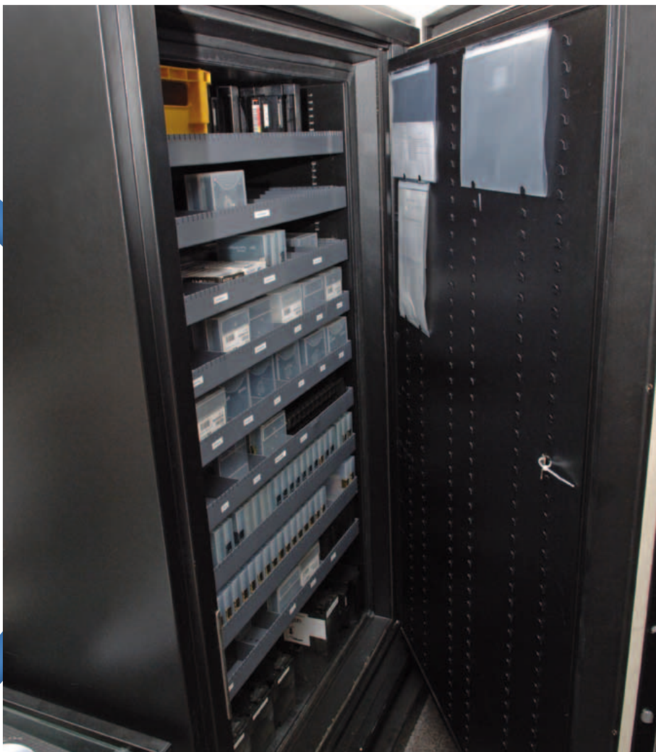
In zertifizierten Datensicherungstresoren sind Magnetbänder sicher vor Diebstahl und Umwelteinflüssen
