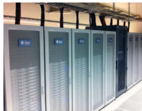
Cluster im HZG-Rechenzentrum
