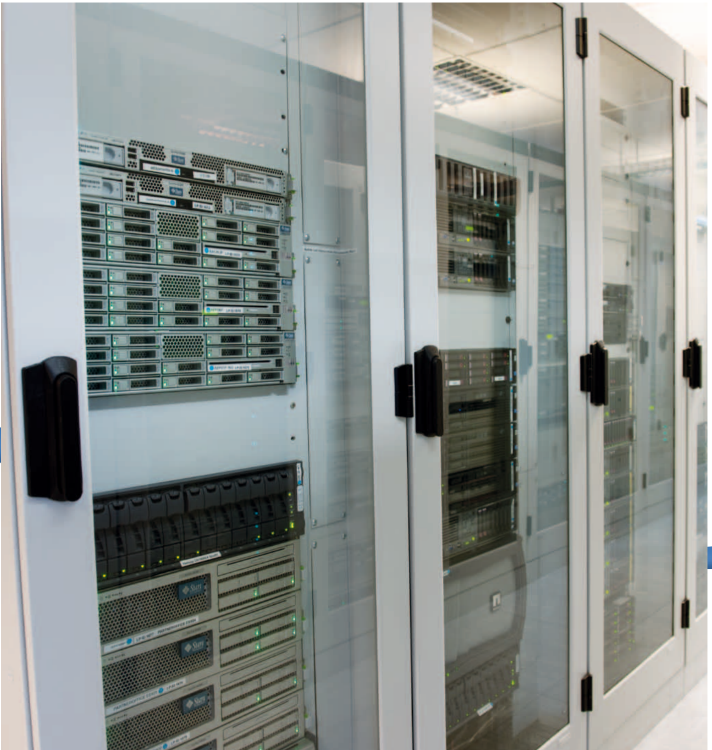
Stromeffizient und intelligent gekühlt: Die 19-Zoll-Serverschränke im Rechenzentrum SR2
