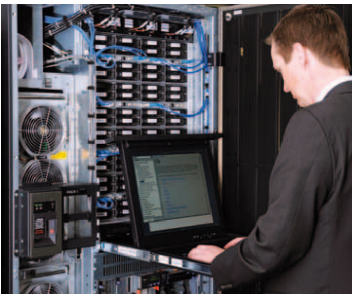
Serverschrank im Rechenzentrum
